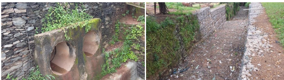
Figura 230: Rua Tocantins-saída de bueiro e início de gabião.
