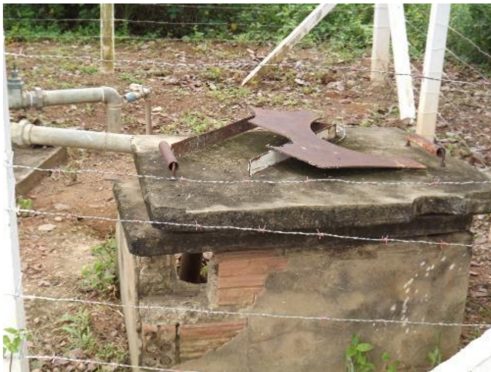
Figura 170 - Poço Tubular Profundo – Distrito de Santa Luzia
