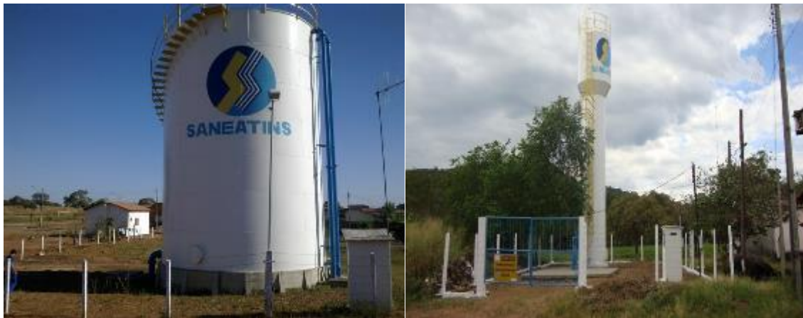
Figura 167 - Reservatórios: RAP-003 e REL-004 (junto ao PTP-001 – Vila Chapadão)
