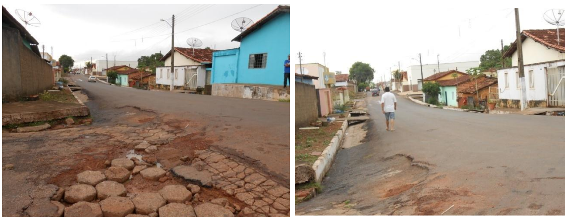
Figura 283 - Rua 13 de maio Empossamento
