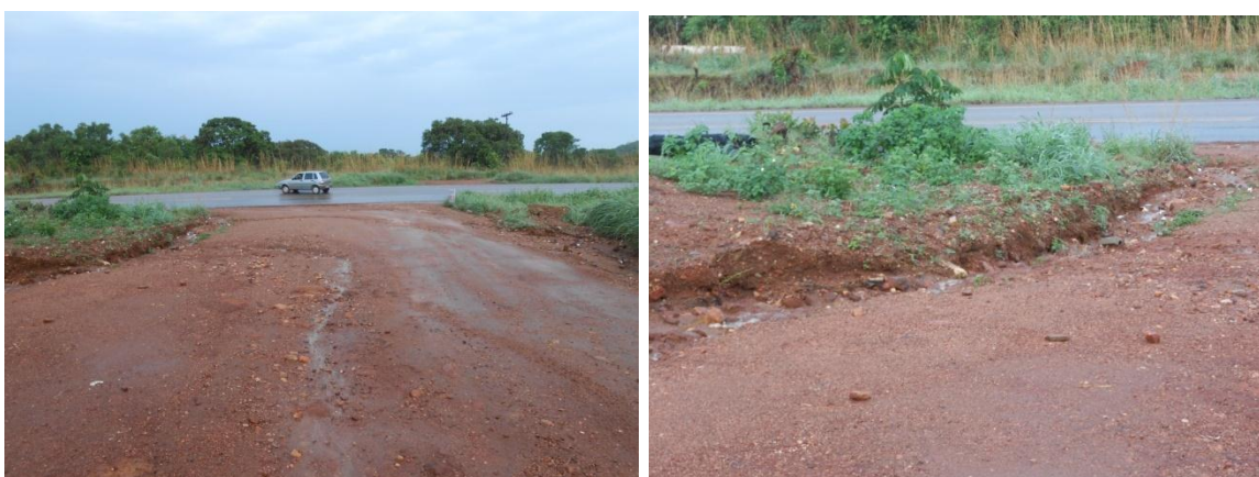
Figura 332 - Rua 10 com TO-080 Empossamento
