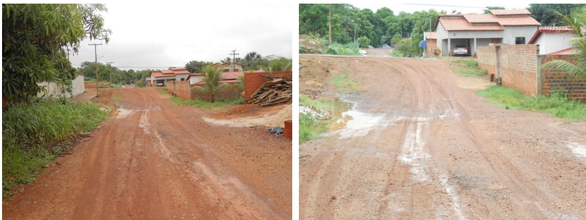
Figura 278 - Avenida Carlos Savaré com Rua Graça Aranha Erosão
