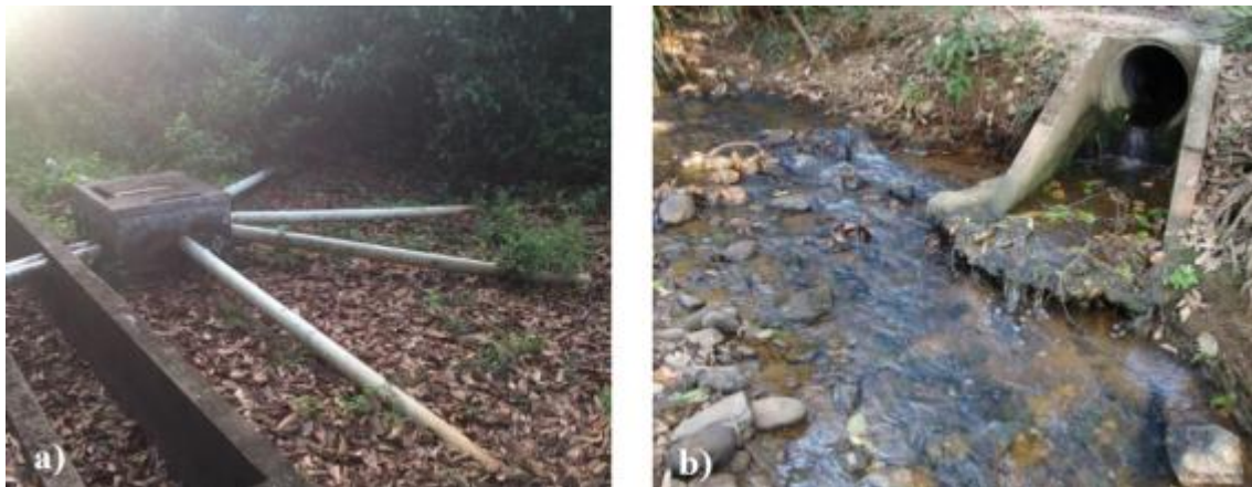
Figura 219: a) Distribuição do efluente no solo; b) Lançamento no Córrego Pernada. Fonte: Almeida apud Odebrecht Ambiental/Saneatins, 2016.
