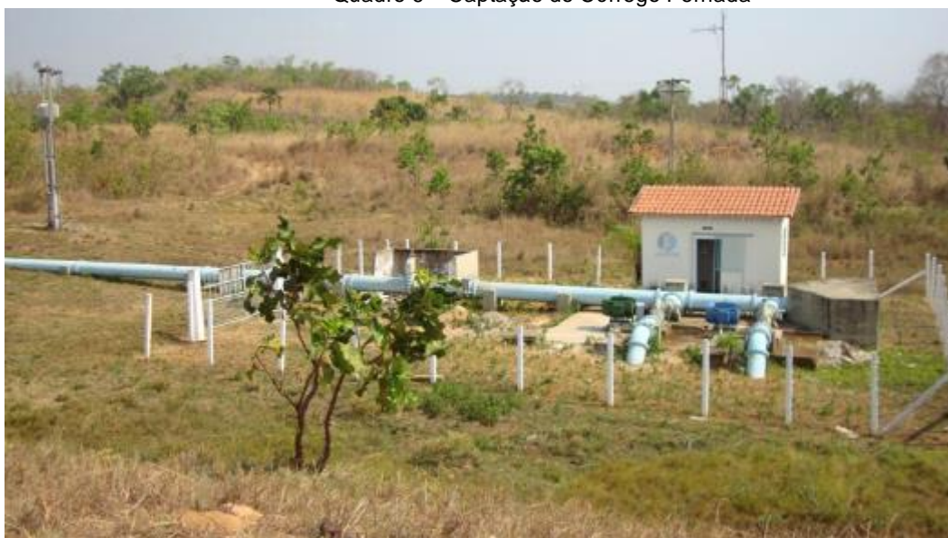
Figura 161 Adutora de Água Bruta da Barragem do Rio do Coco
