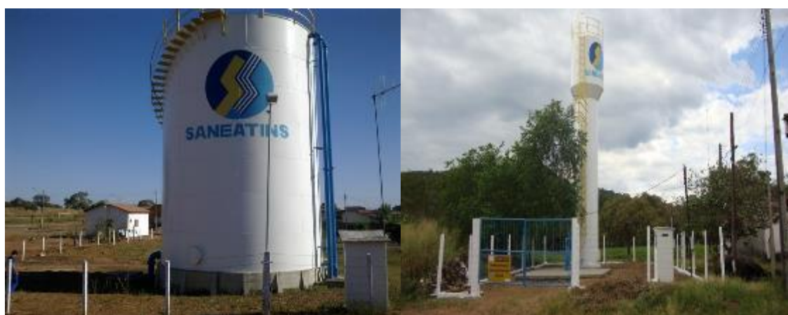
Figura 181 - Reservatórios: RAP-003 e REL-004 (junto ao PTP-001 – Vila Chapadão)
