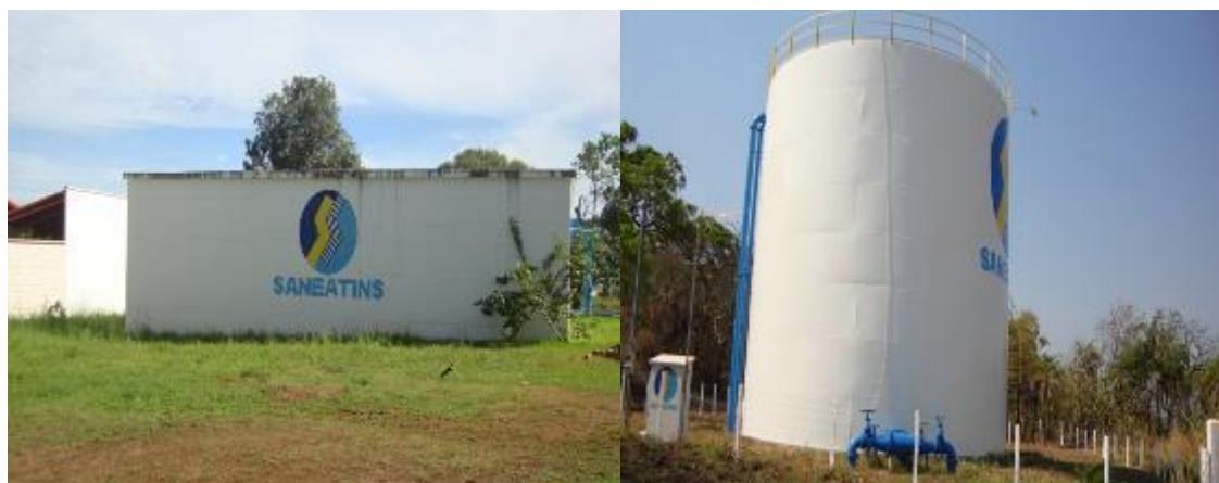
Figura 180 - Reservatórios: RAP-001 e RAP-002
