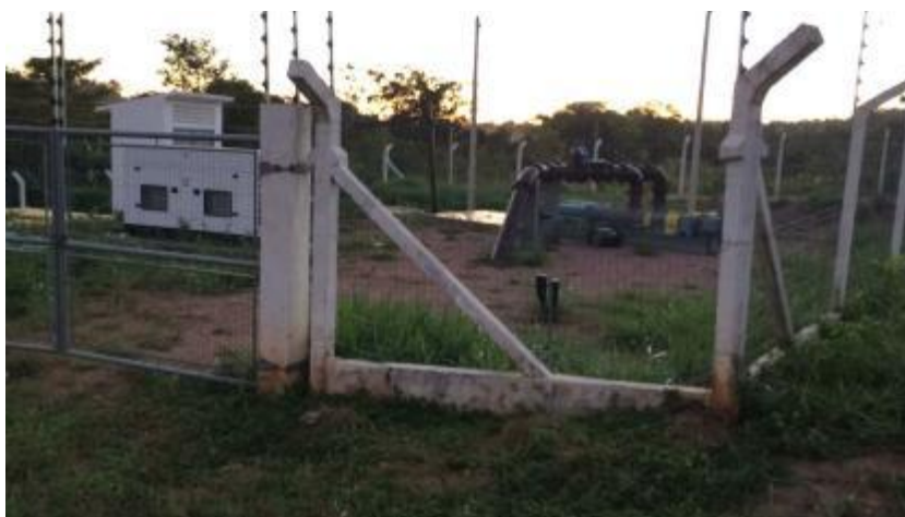
Figura 186: Estação elevatória de esgoto, do município de Paraíso do Tocantins.
