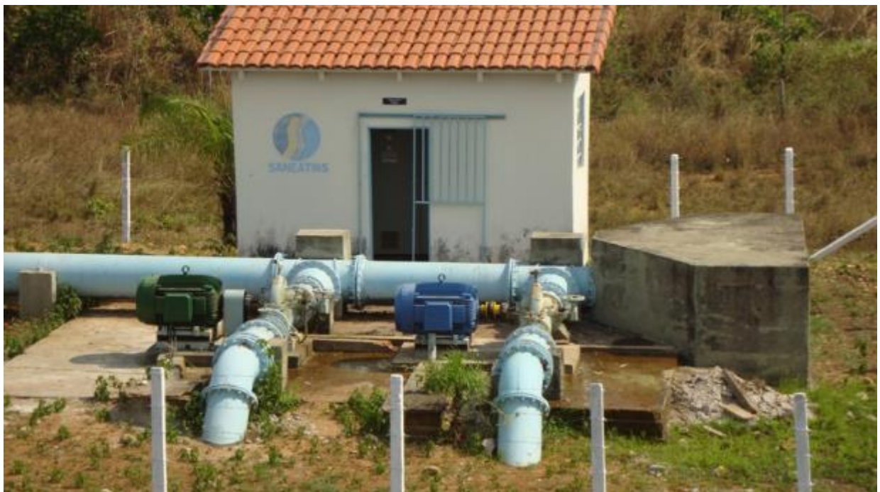
Figura 164 - Estação Elevatória de Água Bruta – EAB-002 – Rio do Coco
