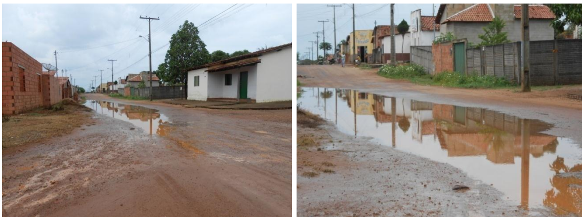
Figura 350 - Rua Portugal Nº 1815 Empossamento
