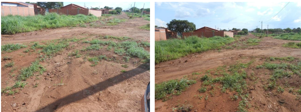
Figura 245 - Av. B Erosão
