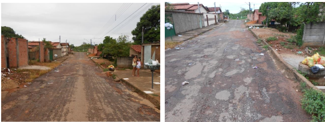
Figura 289 - Rua Minas Gerais Empossamento
