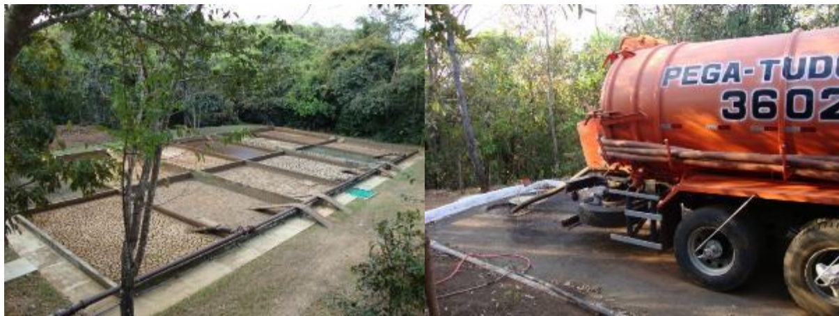
Figura 193 - Leitões de Secagem de Lodo e Ponto de Recebimento de Limpa Fossas
