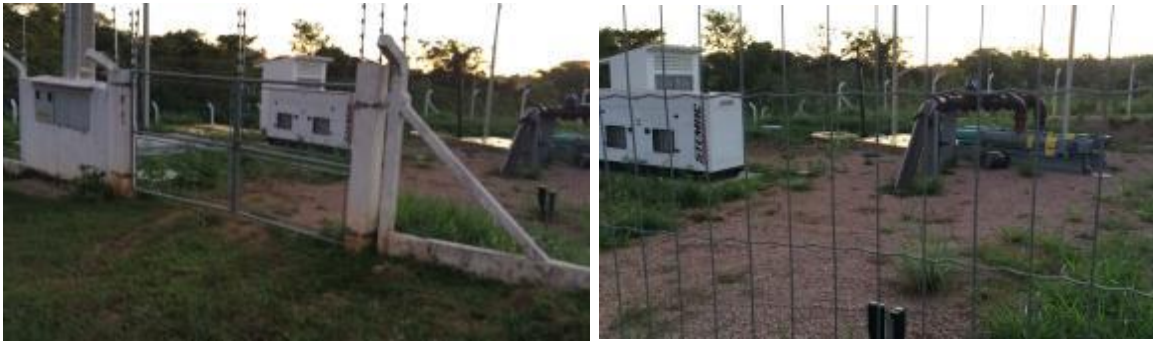
Figura 217: Infraestrutura da ETE - 01 de Paraíso do Tocantins.
