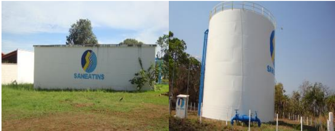
Figura 166 - Reservatórios: RAP-001 e RAP-002
