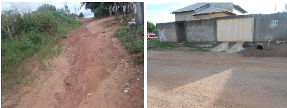
Figura 240 - Rua 04 A em direção à Rua 15 Final da erosão e início do areal
