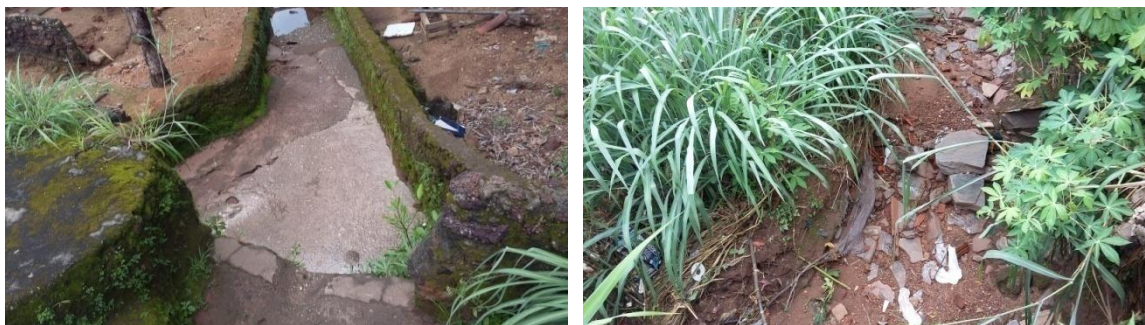
Figura 229: Canaleta na rua 02 (a céu aberto) e na rua Tocantins, Vila Regina.
