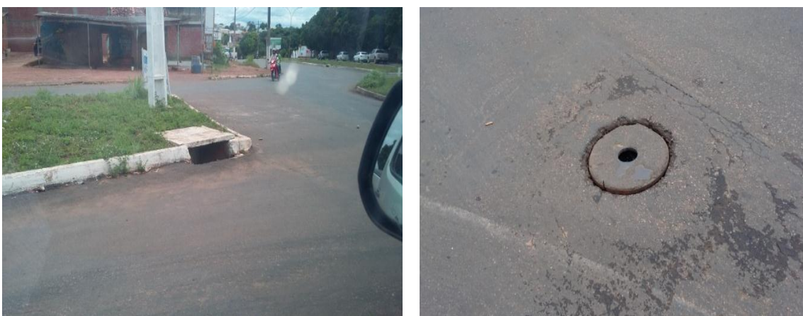
Figura 225: Captação de água pluvial na Avenida Santos Dumond esq. com rua 5 (Setor Oeste) e Avenida Araraquara (Jardim Milena), respectivamente.
