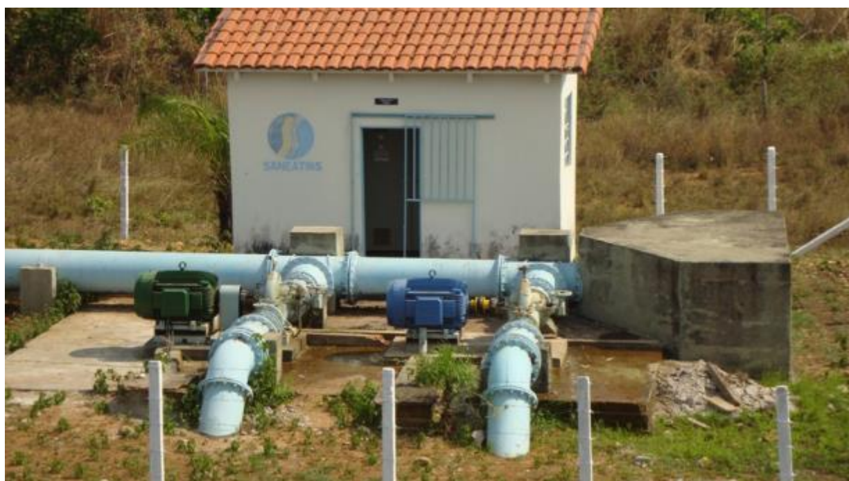
Figura 178 - Estação Elevatória de Água Bruta – EAB-002 – Rio do Coco
