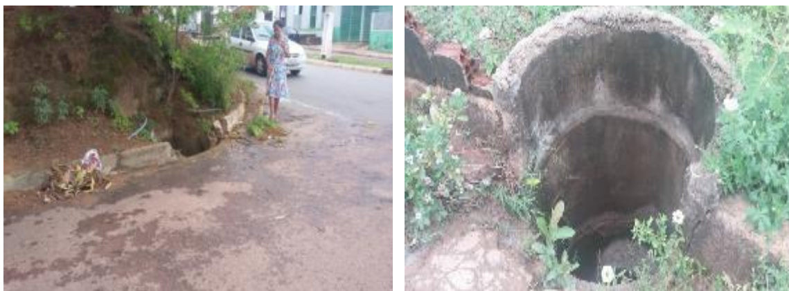
Figura 223: Bueiro da Avenida 23 de outubro eq. com a rua Jose Nezio e Rua 62 eq. com rua 53, respectivamente.
