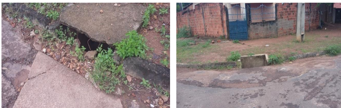
Figura 222: Bueiros da rua 62 e Jose Nezio, respectivamente.
