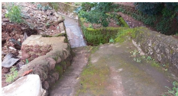
Figura 232: Descarga da água pluvial coletada no Setor Oeste.
