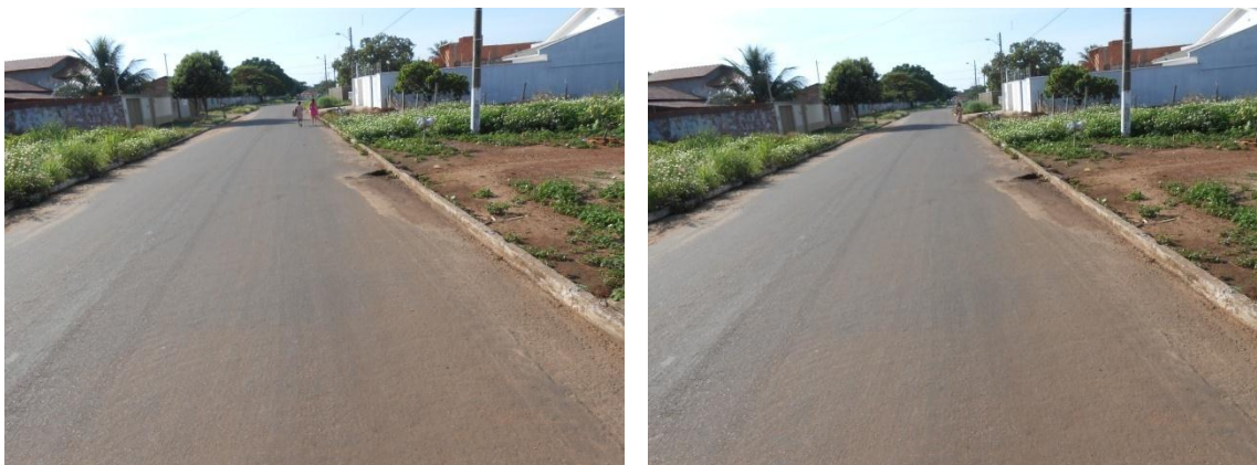
Figura 257 - Avenida Araraquara Umidade constante no pavimento
