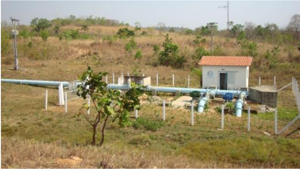
Figura 175 - Adutora de Água Bruta da Barragem do Rio do Coco
