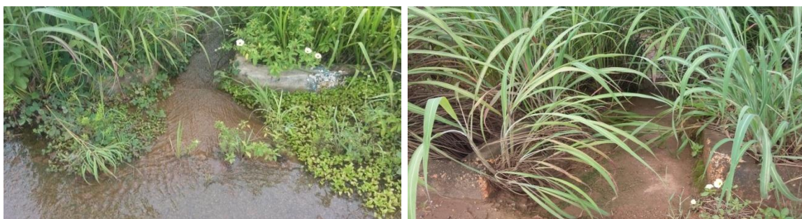
Figura 228: Canaletas na rua Jose Lopes esq. com rua 50 e da Avenida Paraíso, respectivamente Alto Paraíso e Vila Regina.
