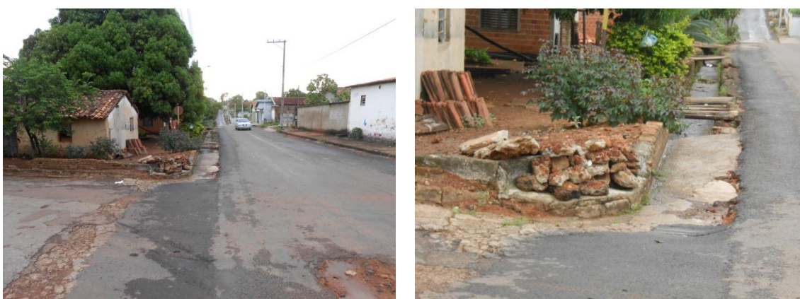
Figura 286 - Rua Araguaína com Avenida Goiás Erosão
